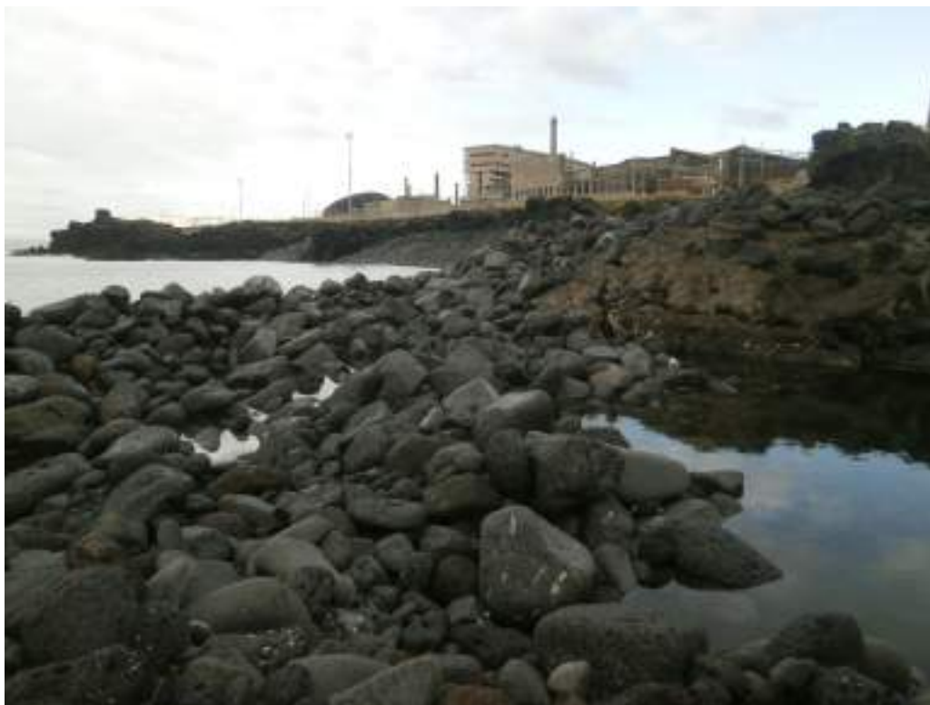
Figura. Indebolimento alla base del braccio esistente per azione del mare e chiusura dell'imboccatura del porto
